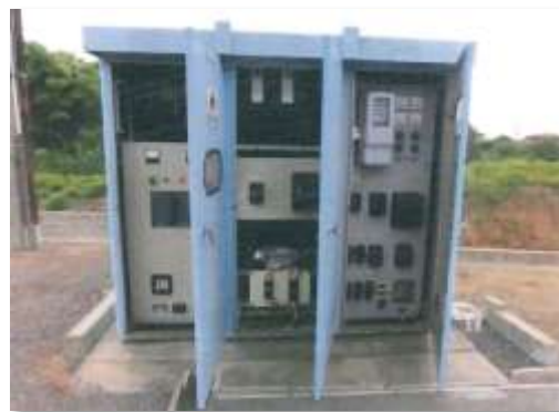
高圧受電設備
