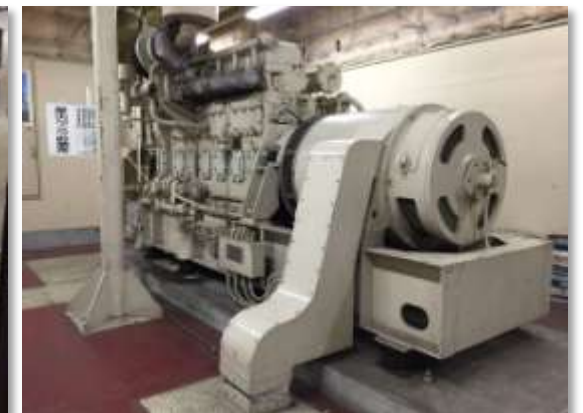
非常用自家発電機設備
