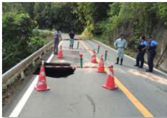
国道163号の道路陥没 (美里町北長野地内)
