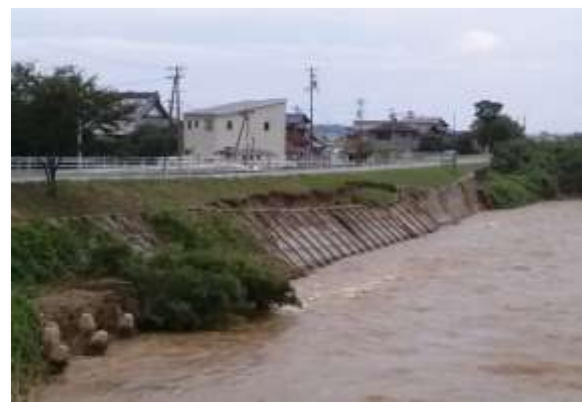
安濃川の護岸崩壊 (安濃町荒木地内)
