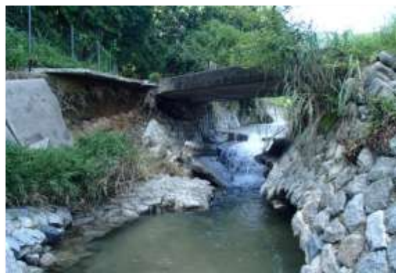
橋りょうの損壊 (美里町穴倉地内)
