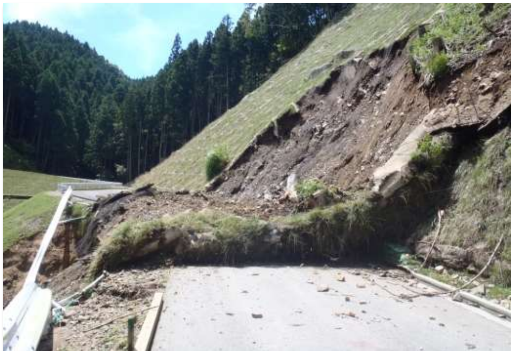
林道の法面・路側崩壊(芸濃町河内地内)
