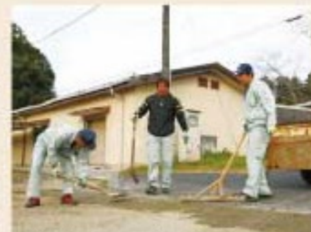
翌日に行われるイベントで使用される駐車場の環境整備を行っています。補修や整備作業を丁寧に行うことで、事故の発生を未然に防いでいます。
