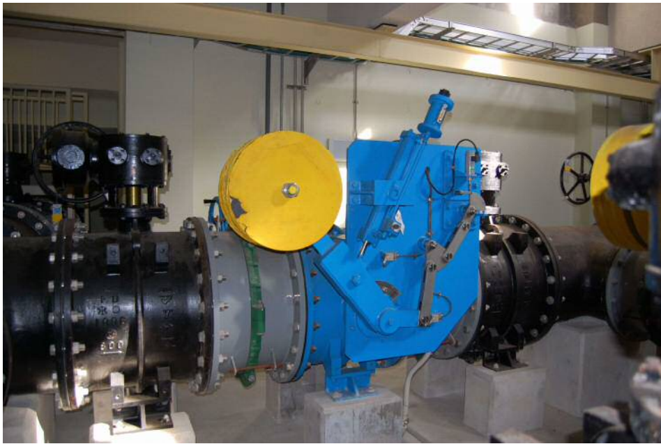
図 5.6 緊急遮断弁（大里受水場 口径 800 ミリ）
