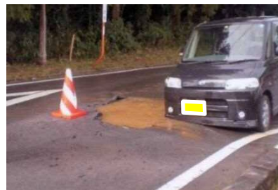
漏水事故による道路陥没
