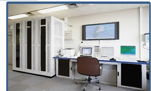
地域防災情報通信システム
