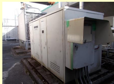
改修が必要な美里文化センター 冷水水発生機
