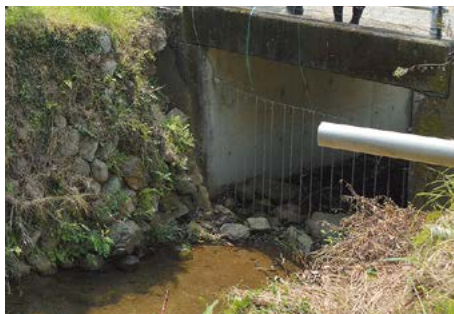
水路に設置された電気柵(フラッドゲート)
