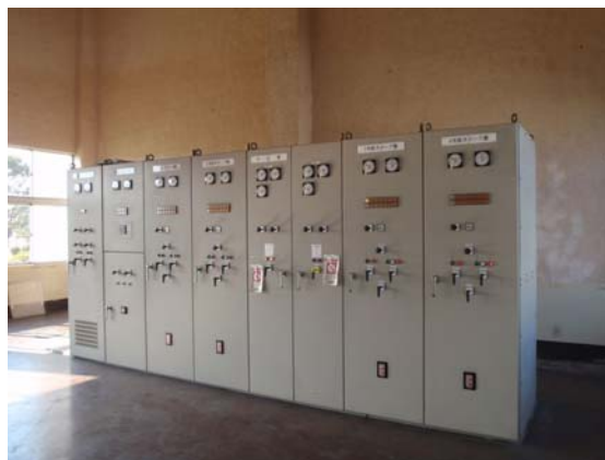
写真-7 電気計装設備 (三雲浄水場)
