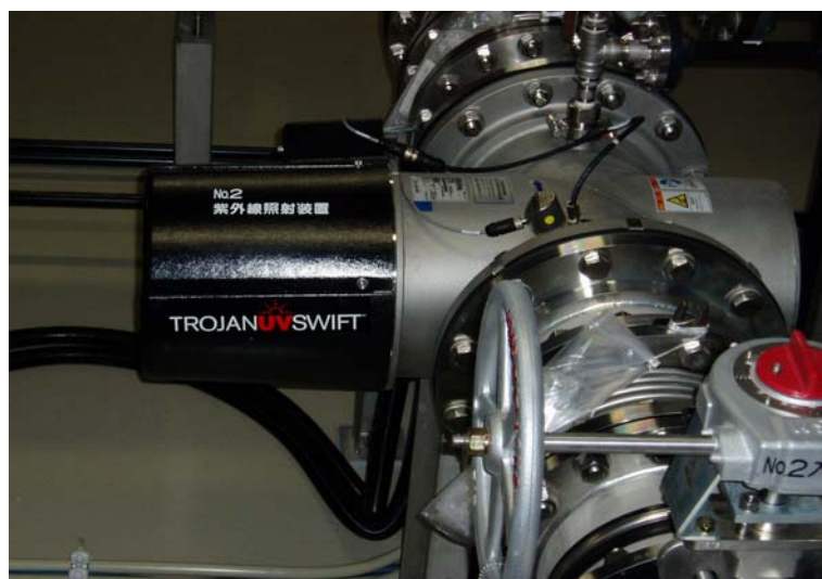
写真-13 紫外線処理設備 (高茶屋浄水場)
