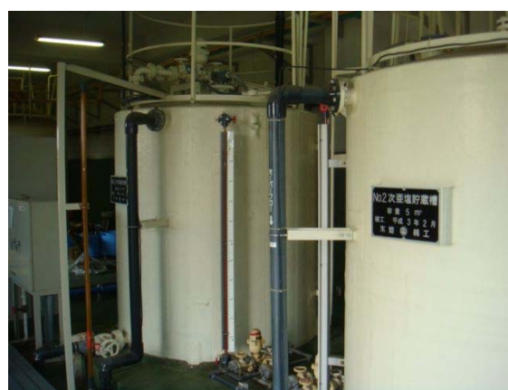
写真-4 塩素注入設備 (三雲浄水場)
