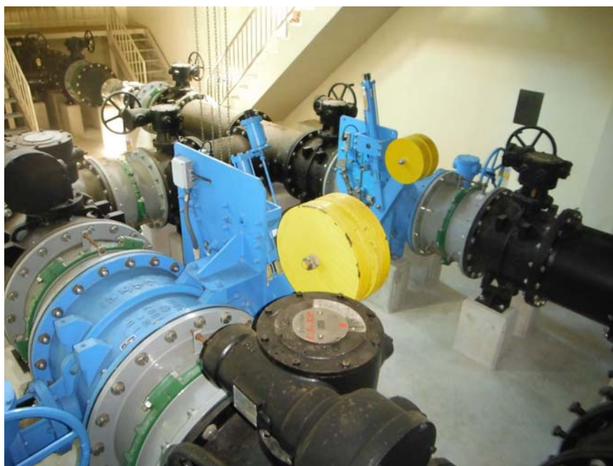
写真－8 緊急遮断弁(大里受水場)
