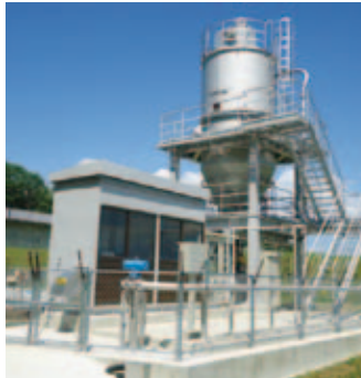
片田浄水場の急速ろ過設備 活性炭投入設備
