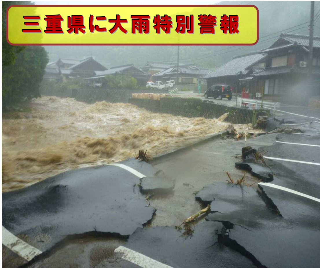
↑ 白山地域の河川氾濫状況
