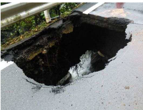
↑ 美里地域の道路陥没現場
