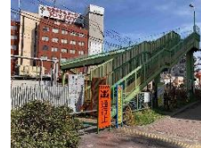
通行止めの横断歩道橋
