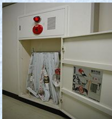
(屋内消火栓設備)
