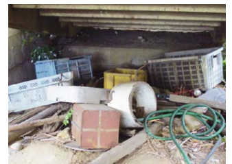
高架下に投棄されたごみ
