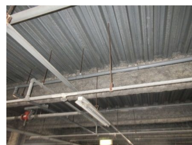
ポルタひさい駐車場 照明器具
