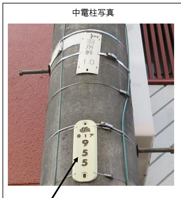
(下プレートが中部電力の電柱)
