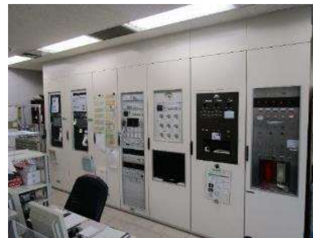
中央監視装置 (地階から本庁舎3階へ)
