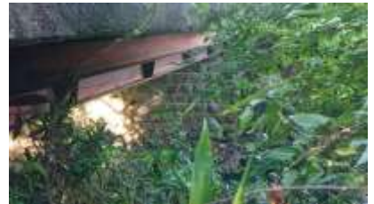
蛇川に架かる橋の下に、中勢鉄道時代の橋台が残されています。
