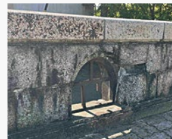
塔世橋に残る爆撃の跡
