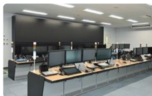
運用予定の三重中央消防指令センター
