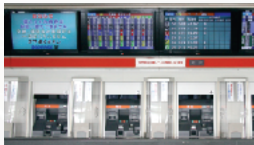
新しくなった場内映像設備（液晶モニター）と4点以上のボックス購入や1軸固定の流しの購入が可能な自動券発機
